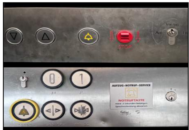
Abb.13: Aufzugbedienung (Funktion freie - effektivere - Fahrt = Vorzug)
